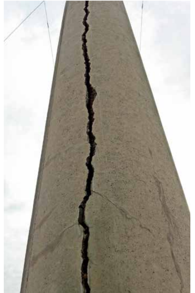
Sanacija velikih razpok na betonskih stebrih je draga, ponekod celo dražja od postavitve novega stebra.
